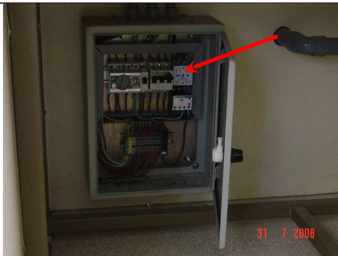
Part metàl·lica desprotegida
