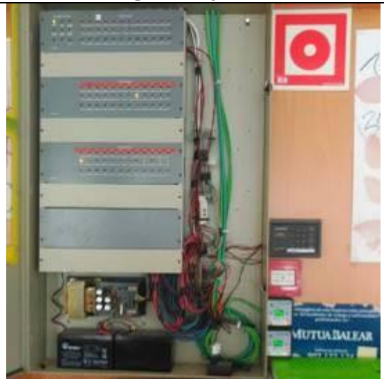
6. Centraleta d'incendis del bloc A
