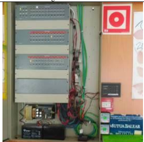
4. Centraleta d'incendis del bloc A
