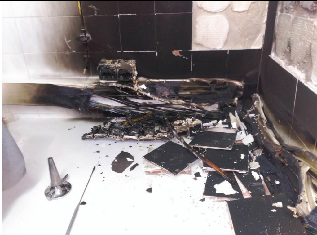
El foc ha cremat la màniga de gas i la capsa de cablejat
